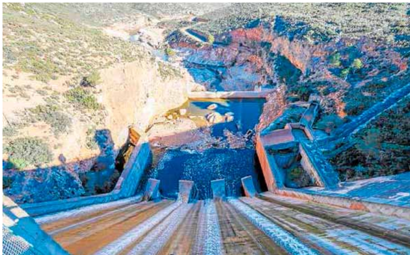
Daños ocasionados por la dana en la presa de Forata. IRENE MARSILLA
